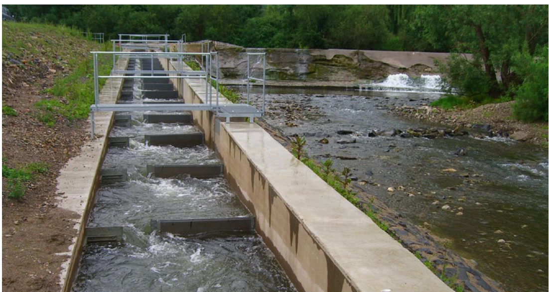
Abbildung 6: Fischwanderhilfen wie dieser Schlitz-Pass, sollen die flussaufwärtsgerichtete Wanderung von Fischen und anderen aquatischen Organismen, vorbei an den zur Wasserkraftnutzung errichteten Wehren, ermöglichen. Bildquelle: Christine Lecour, LAVES - Dezernat Binnenfischerei
