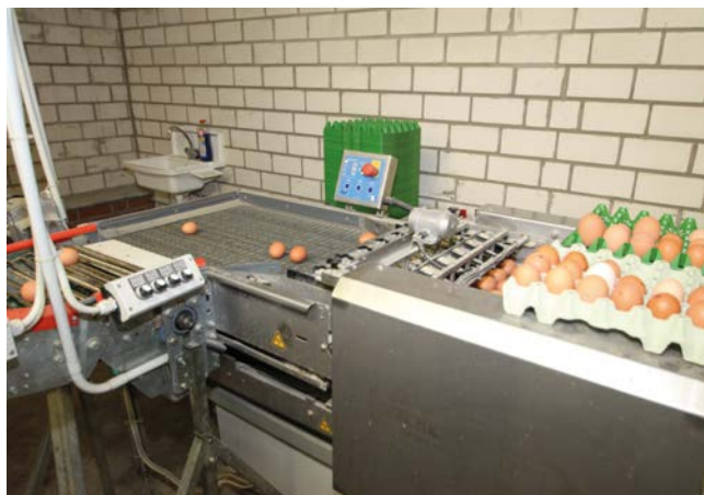
Abb. 26: Zwischen den beiden umgebauten Ställen befindet sich die Eiersortier- und Verpackanlage. Quelle: M. Ziron
